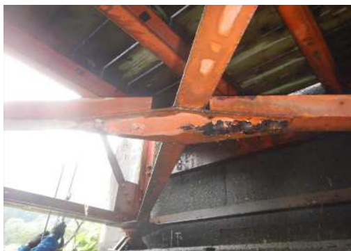
鋼桁の腐食等
