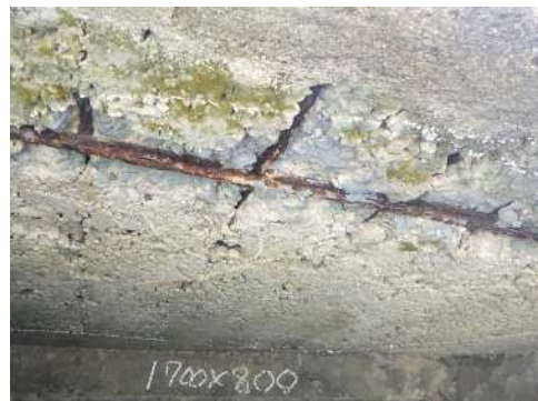
コンクリート橋の剥離・鉄筋露出
